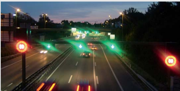
VBA in der Vorzone eines Tunnels
